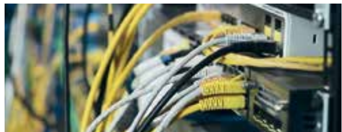
Datenanschlüsse im Wirecenter
